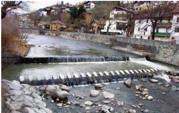
Abb. 2-14: Wanderhindernis für Gewässerlebewesen.
