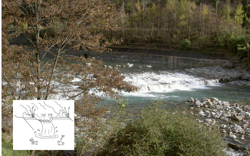
Umbau Sohlstufe Kläranlage "Unteres Eisacktal" Ristrutturazione della briglia presso il depuratore "Bassa Val Isarco"
