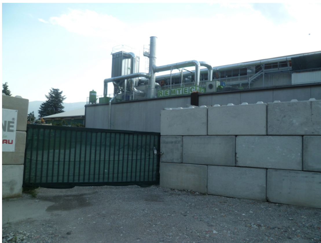
Figura 59 - Utilizzo a capacità ridotta del sistema di filtrazione.
