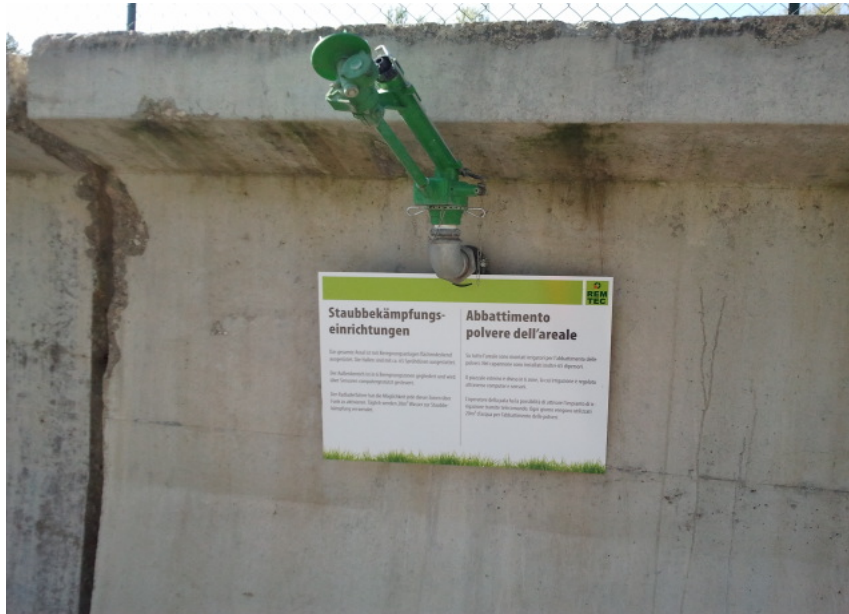
Figura 38 - Impianto di “irrigazione” per inumidire l’aria e il materiale trattato, al fine di ottenere un apprezzabile abbattimento delle polveri.
