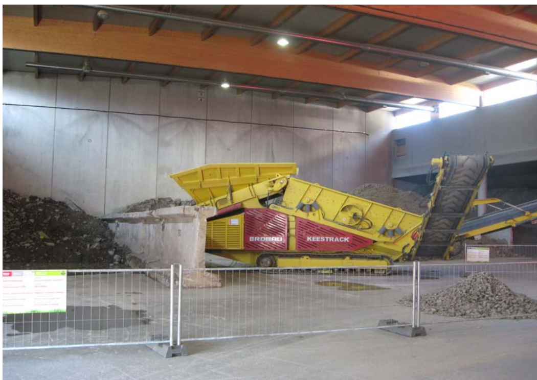
Figura 7: Vaglio all'interno del capannone 1 (sul soffitto si vedono i tubi dell'impianto di aspirazione dell'aria).
