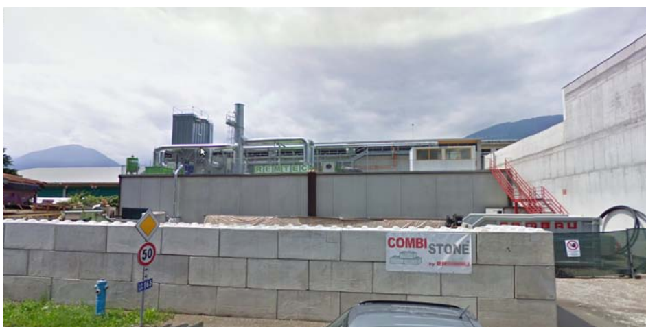
Figura 2: Vista nella fase di costruzione dalla strada del retro del capannone 1 della ditta REM-TEC: si nota l'impianto di aspirazione e depurazione fumi sul tetto. A sinistra si vedono le serrande automatizzate verdi del capannone 2. Infine in primo piano il muro costruito con i "Combi Stone".
