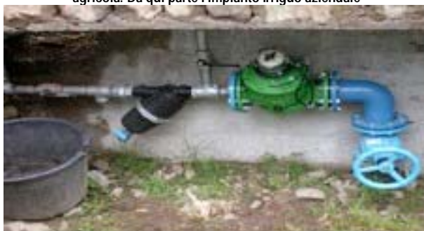
Illustrazione 2 – Un punto di adduzione dell'acqua ad un'azienda agricola. Da qui parte l'impianto irriguo aziendale
